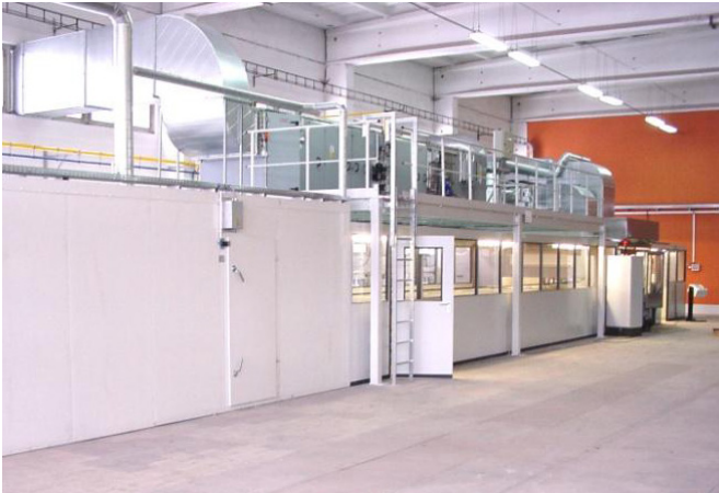
Flächenspritzer mit 2-Etagen Umluft-trockner und Lüftungstechnik
