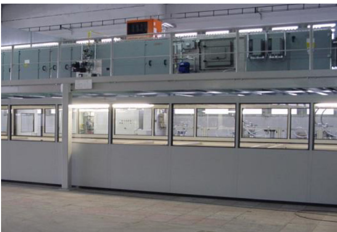
Zuluftanlage für gefilterte und klimatisierte Luft
